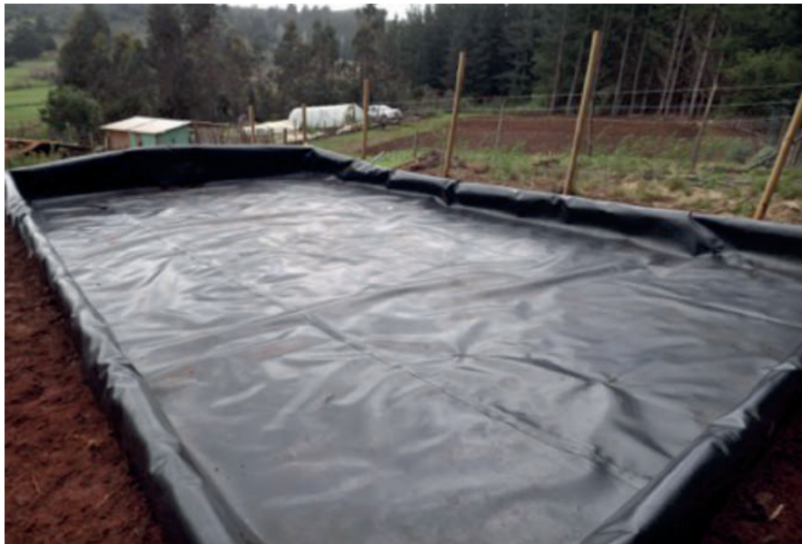
Figura 80: área de captación de geomembrana
