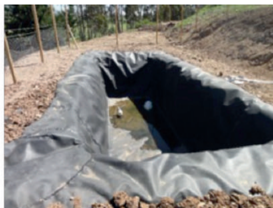
Figura 48. Área de acumulación con cubierta en Geomembrana HD de 1 mm de espesor.
