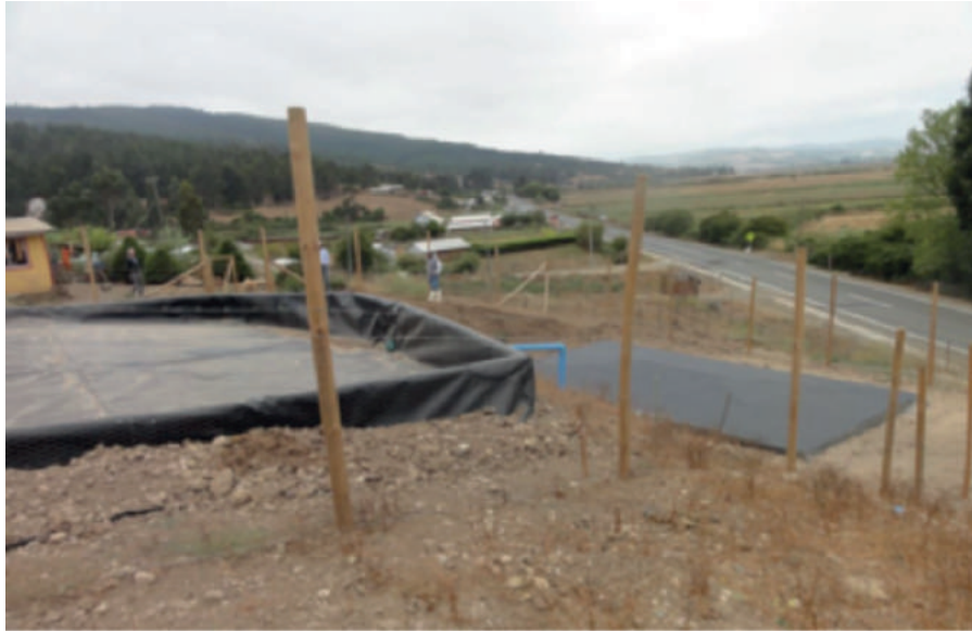
Figura 79: sistema de almacenamiento de agua lluvia con geomembrana
