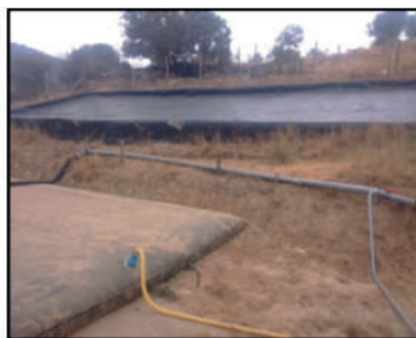
Figura 109: tuberías de sistema de lavado
