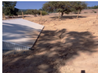
Figura 114: el trabajo con maquinaria remueve mucho material y deja muy expuesto el terreno. Esto facilita la entrada de agua a la zona de acumulación, pudiendo generar un socavón por todo el perímetro de la unidad, como ocurrió en 2014 en el Sector Rarín.
