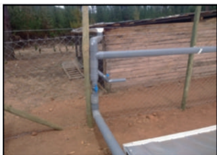
Figura 108: tuberías de sistema de lavado
