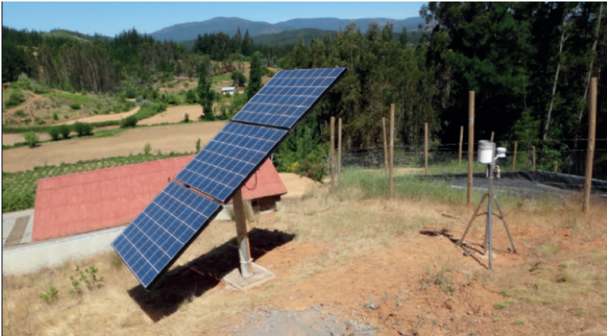
Figura 74: planta fotovoltaica del sistema de captación sector Los Molinos, Curepto.
