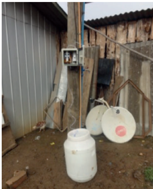
Figura 88: sistema de cloración de los sistemas de captación de aguas lluvias
