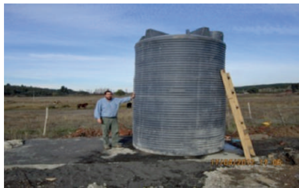
Figura 8: estanque de polietileno.
