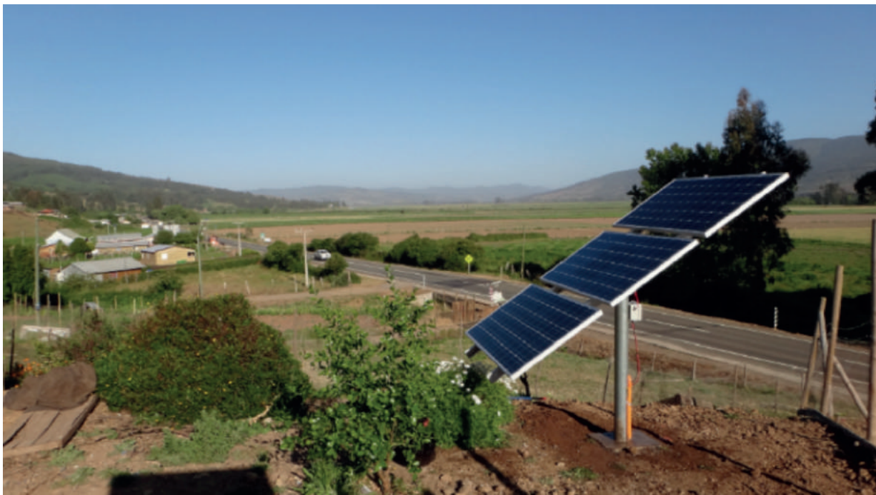
Figura 75: planta fotovoltaica del sistema de captación sector El Huapi, Licantén.
