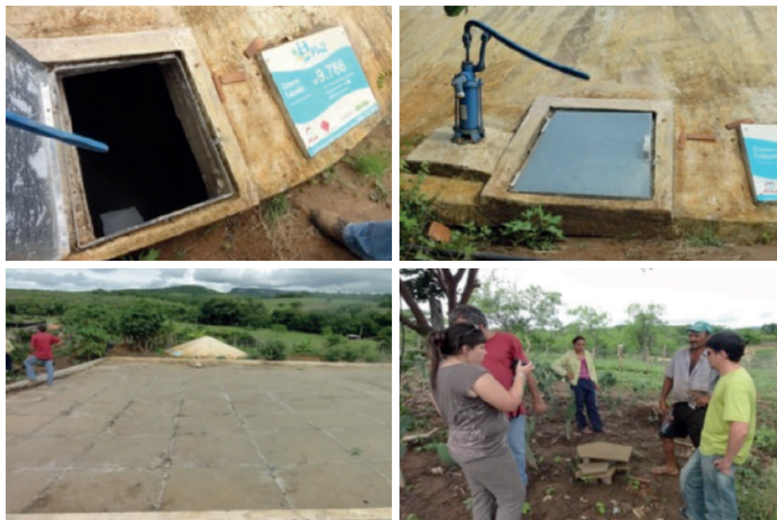
Figura 28: cisternas de acumulación de aguas lluvias, Comunidad Humaita Municipio de Itinga.
