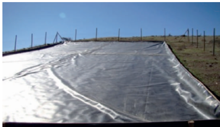
Figura 9: área de captación de geomembrana.
